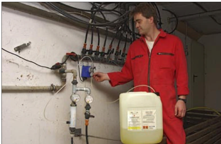
Mit einer Stellschraube erfolgt die Feinjustierung der Anlage.
