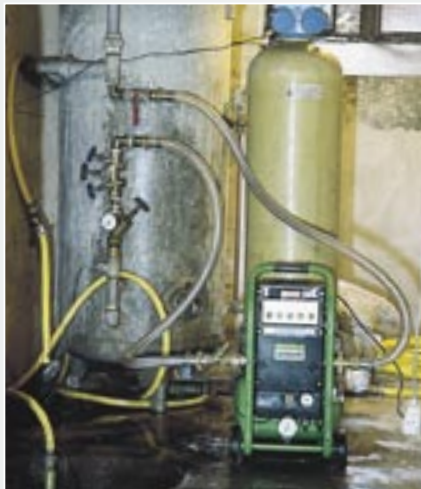
Bei eisenhaltigem Wasser sollten die Leitungen vor einer Desinfektion mit einem Spülkompressor gereinigt werden.
